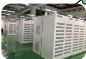
母島発電所 蓄電池
