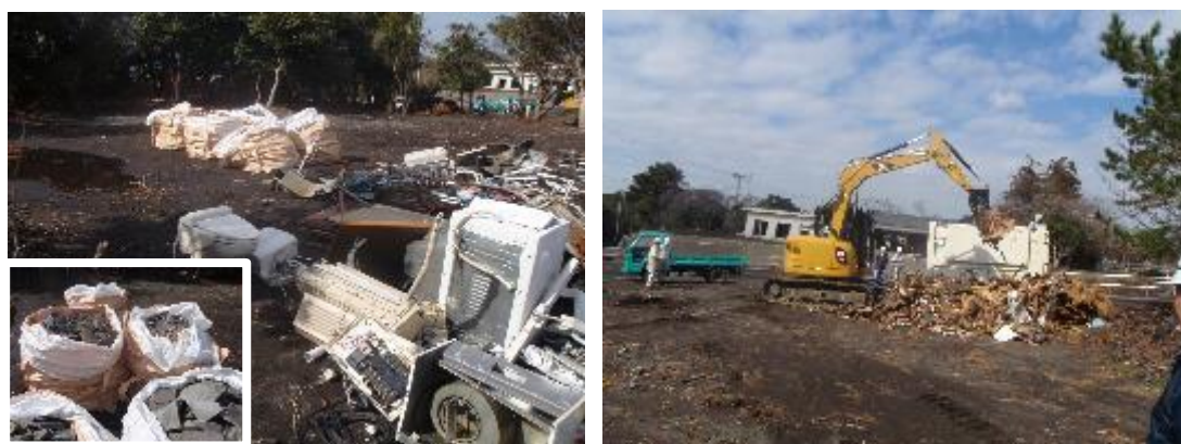
図 4-7 被災現場での粗選別状況(左:分別状況、左下:スレート、右:混合廃棄物積込)
