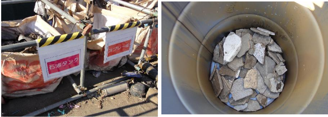
図 4-3 仮置場での危険物・有害物の保管状況(左:危険物、右:石綿含有建材(みなし))
