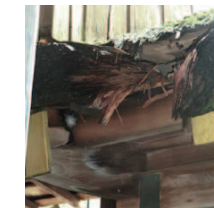
家屋に侵入し、建物損害、糞尿による汚損等を引き起こす。（関西野生生物研究所提供）
