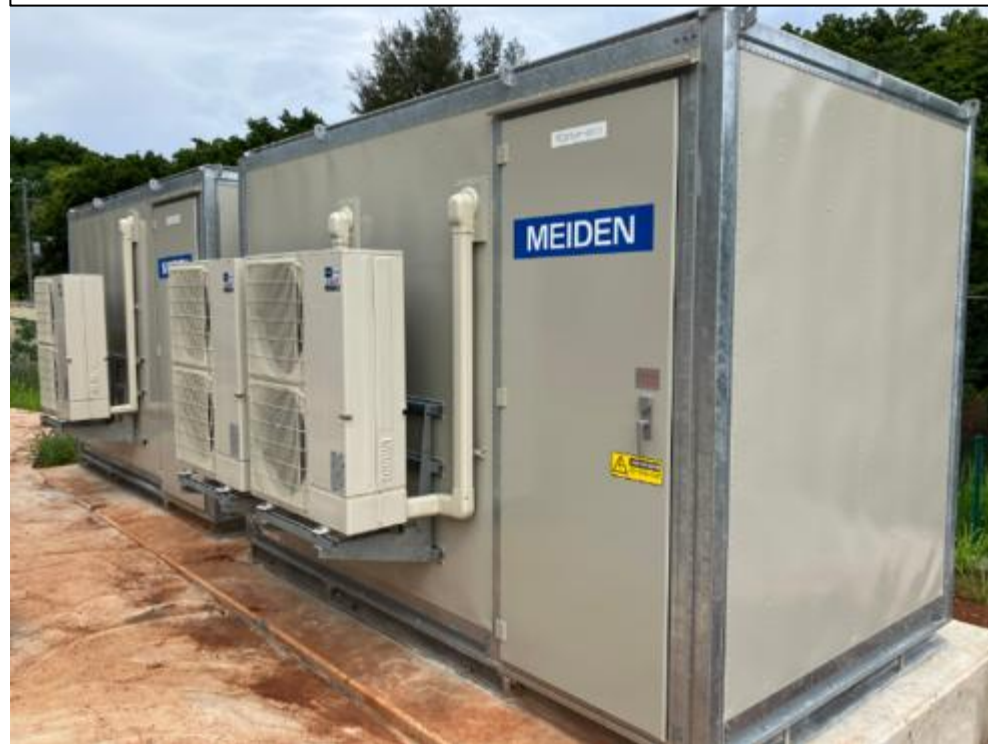
設備へ低反射性の塗料を塗布
