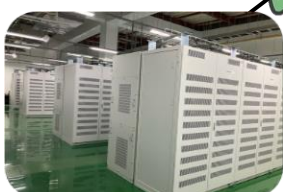
母島発電所 蓄電池
