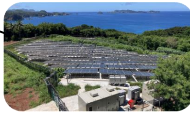
御幸之浜太陽光発電所
